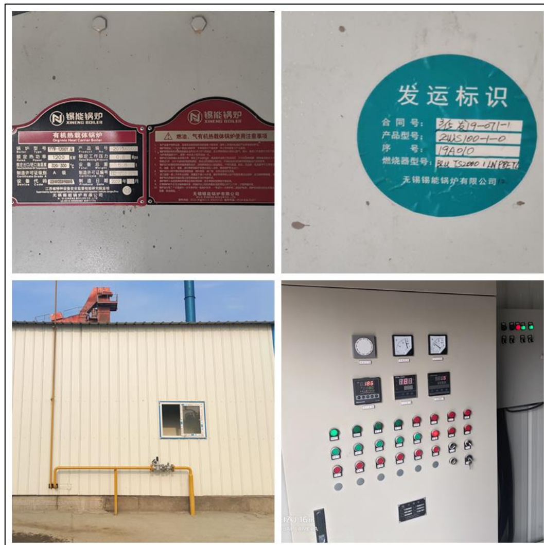
图 2-3 导热油加热炉（燃气锅炉）
