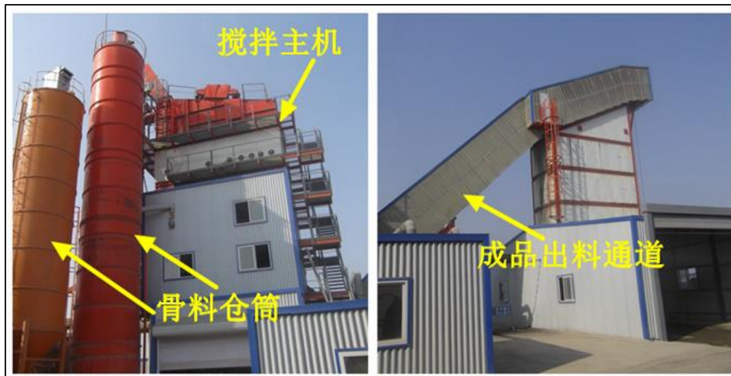
图 2-2 项目主体工程搅拌站（沥青混凝土生产线）
